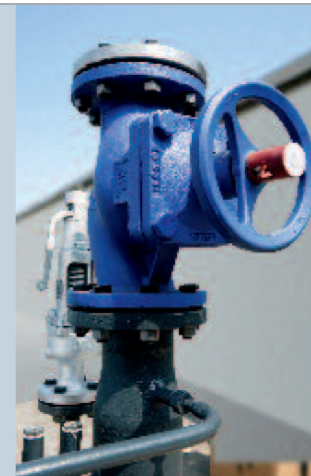
valvola presa vapore e di sicurezza
