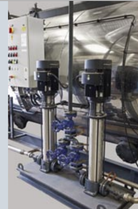
gruppo pompe di alimentazione
